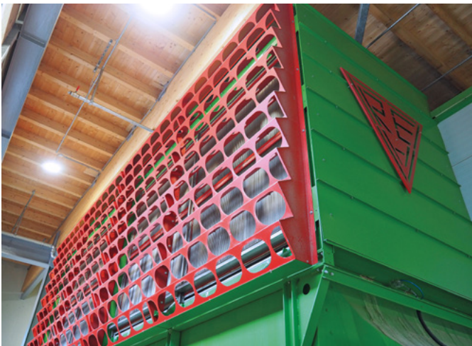
Für einen effizienten Betrieb des Bandrockners installierte Rudnick & Enners einen Bandrockner mit Wärmerückgewinnung
