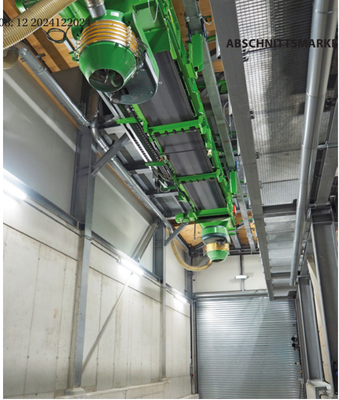
Eingehaust: Um den hohen Lärmschutzanforderungen gerecht zu werden, ist die Abfüllanlage komplett geschlossen
