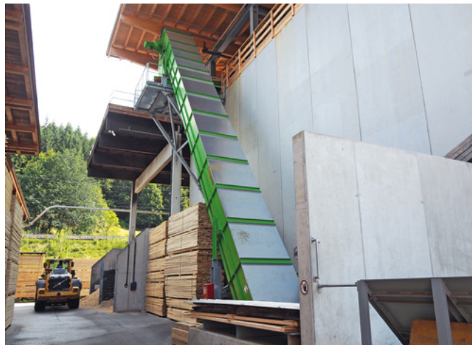
Die Sägespäne werden per Radlader in eine Annahmestation mit Schnellentleerung aufgegeben und nachfolgend in einem 1000 Srm-Bunker gepuffert
